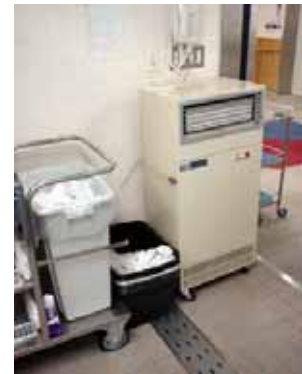
汚物処理室脱臭 （6m 3 /min 室内循環）
